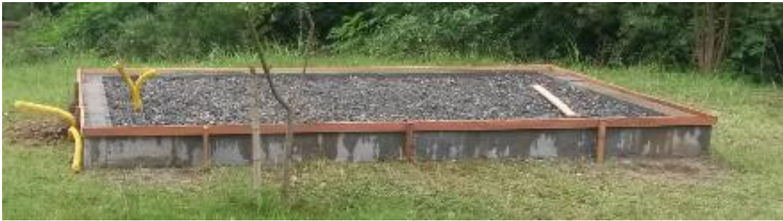
Figura 2 – Quadro de blocos de concreto para fundação e preenchimento com pedras britas.
